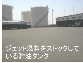
大量に給油が出来る ローリーステーション
