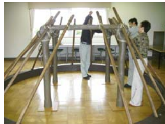
②柱・梁などを縄で結びます。この工程が一番時間がかかります
